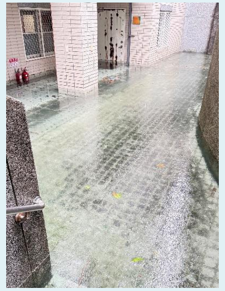
圖 3 地下室天井淹水
