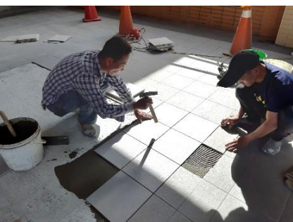
108/12 走廊地坪修繕：突如其來的地磚爆裂，急緊修復。
