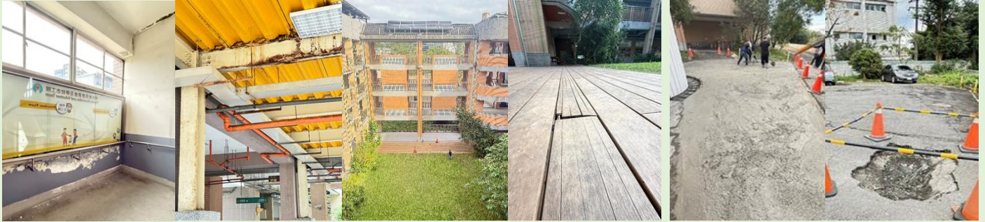
圖 1 國教署 115 年設施設備申請案：校舍油漆粉刷及塑木平台整修
